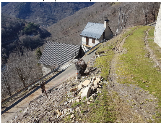
Imatge 07. Estat actual de la carretera de Canejan (del pk 1+323 al pk 1+343)
