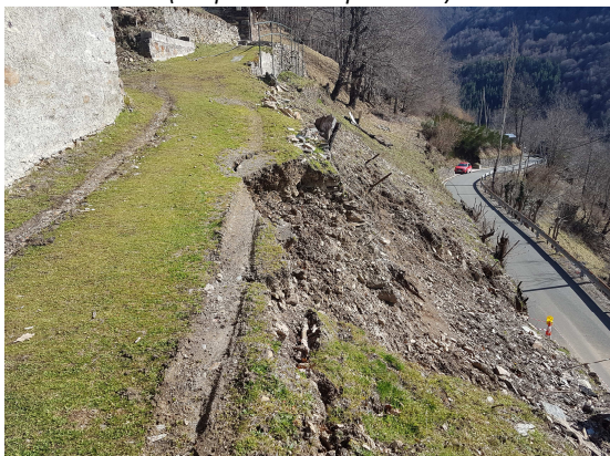
Imatge 06. Estat actual de la carretera de Canejan (del pk 1+323 al pk 1+343)
