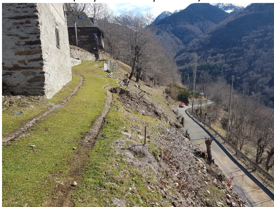
Imatge 05. Estat actual de la carretera de Canejan (del pk 1+323 al pk 1+343)
